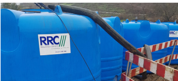
Tanques para el control del pH del agua afluyente del freático que entra en contacto con el hormigón fresco.
