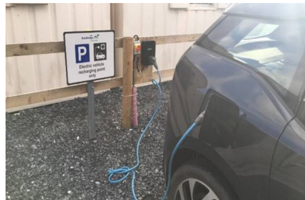
Punto de recarga de coches eléctricos localizado en el aparcamiento de la obra.
