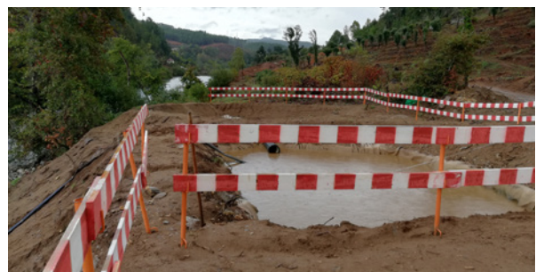
Detalle de la balsa de decantación del agua.
