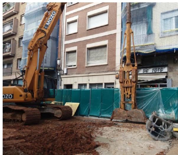
Vista general de los paneles de insonorización en obra. Estación de Metro de Maragall (Barcelona).
