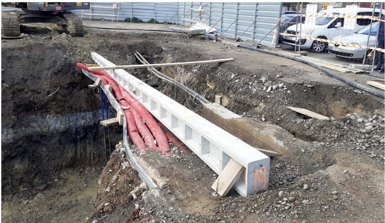
Detalle del apuntalamiento de forma provisional de los servicios afectados para su protección.
