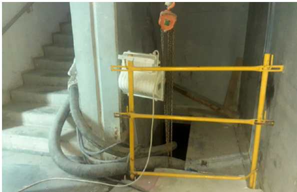
Las tuberías dirigen el agua a través de los niveles del eje hasta el nivel del suelo.
