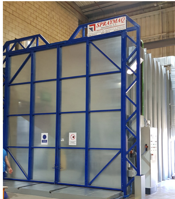
Megaplas. Cabina de proyección instalada.
