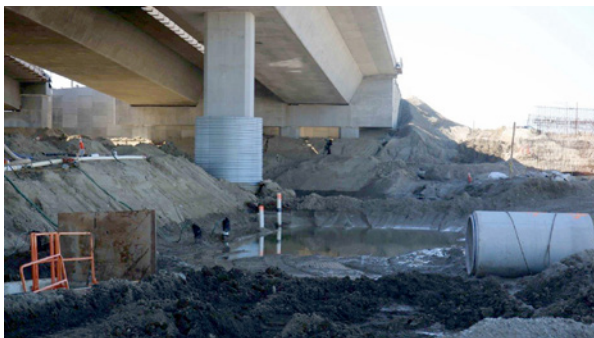
La contaminación del agua subterránea fue una de las principales preocupaciones ambientales durante la construcción del puente Gerald Desmond en California (EEUU). Desde el inicio, en la fase de planificación, se identificaron riesgos relacionados con los vertidos de sustancias contaminantes a las masas superficiales y subterráneas de agua.
