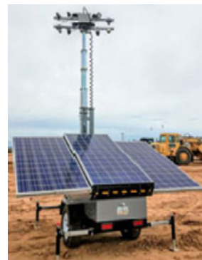
Torre de iluminación híbrida en la obra de la nueva pista del Aeropuerto de Dublín.
