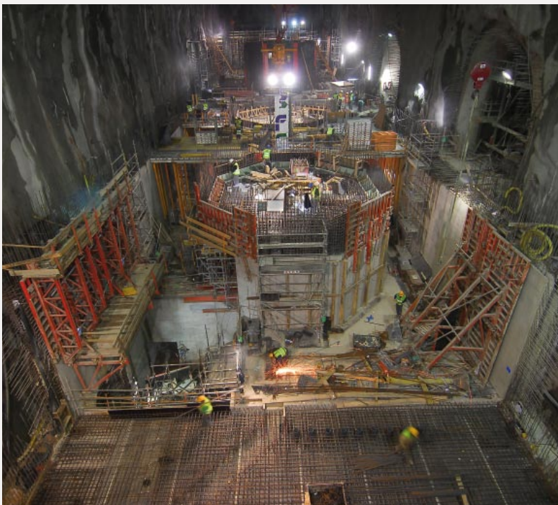
Caverna de la central hidroeléctrica La Muela II (Castellón)
