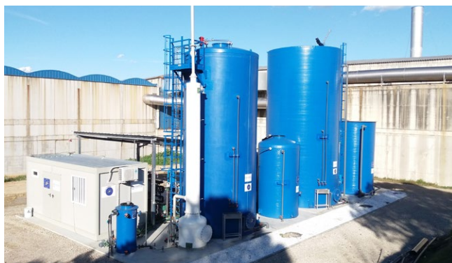
Ecoparque 2 (Barcelona) – Instalaciones de tratamiento para METHAmorphosis.
