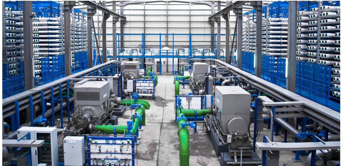
Desaladora de Mostaganem (Argelia).
