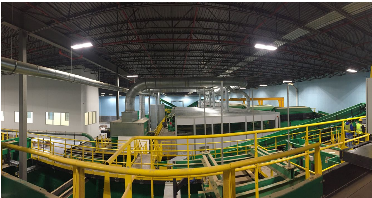
Planta de reciclaje de Dallas (Tejas, EE.UU.).
