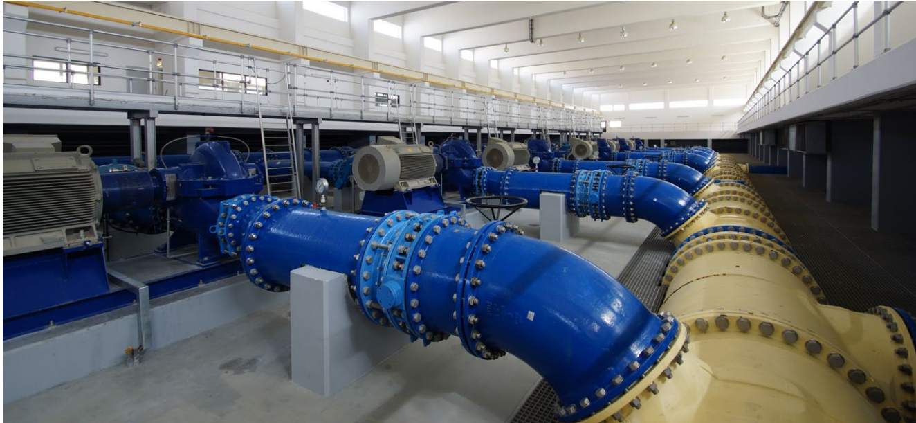
Sohar. Aspiración Intermediate Pumping Station (Omán).
