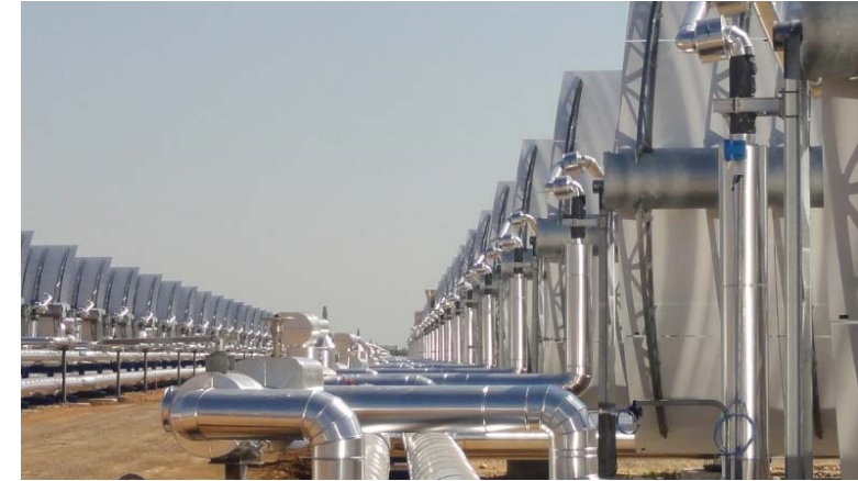
Planta termosolar de Villena, Alicante (España).
