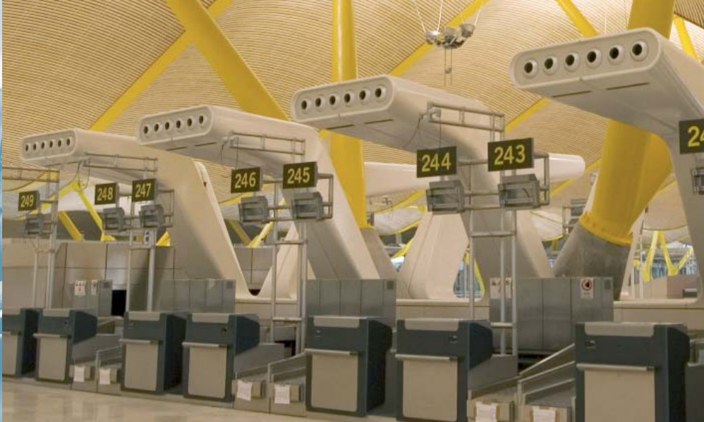
Climatización de la terminal 4 del aeropuerto Madrid-Barajas
