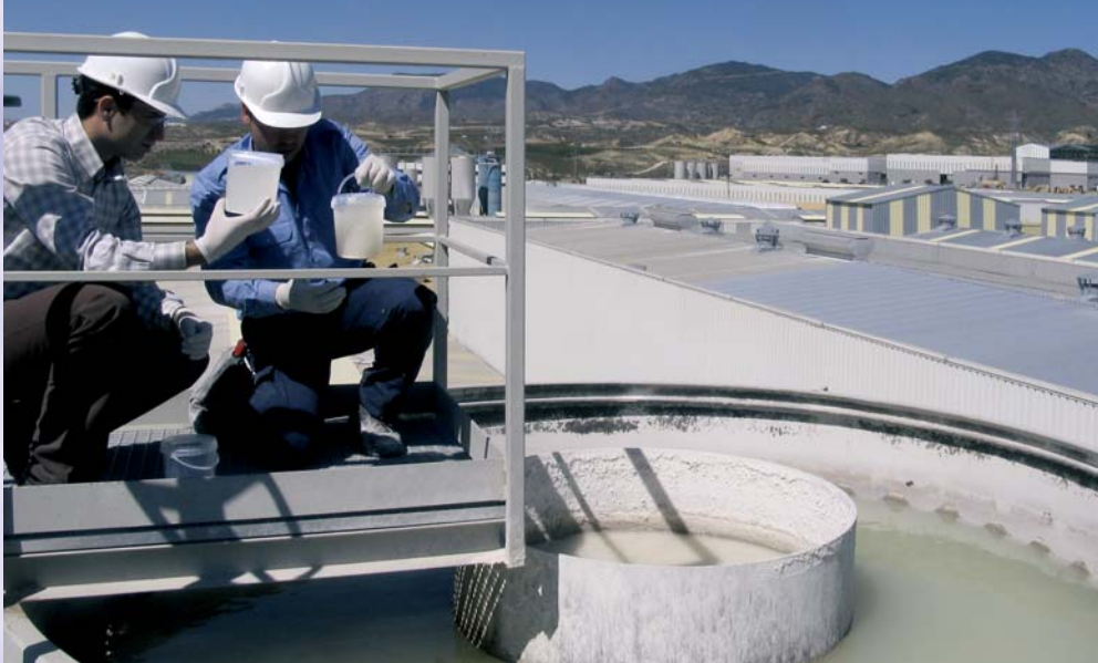
Planta de tratamiento de aguas industriales en Consentino. Almería
