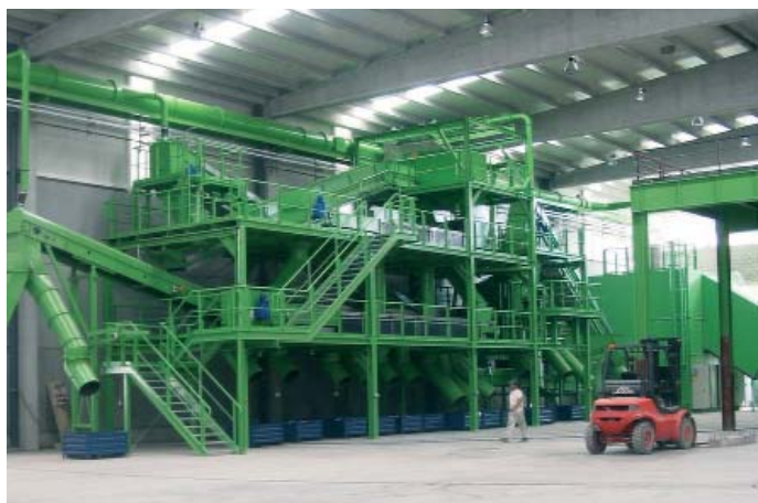
Planta de valorización de residuos de aparatos eléctricos y electrónicos. El Pont de Vilomara. Barcelona
