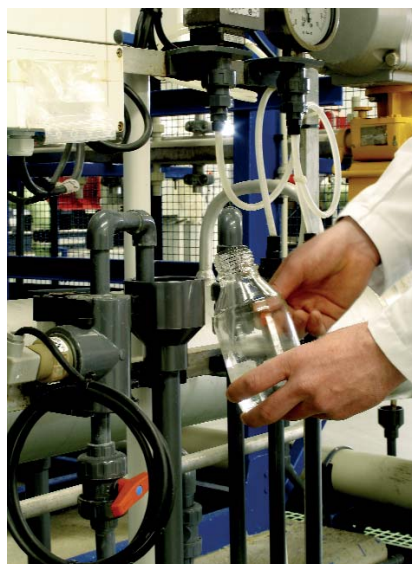
Estación desaladora de agua de mar en Tordera. Girona
