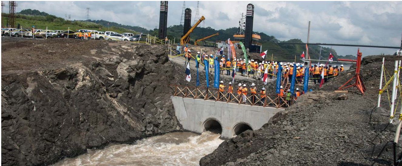
Pruebas de llenado del PAC 4 de la ampliación del Canal de Panamá (Panamá).
