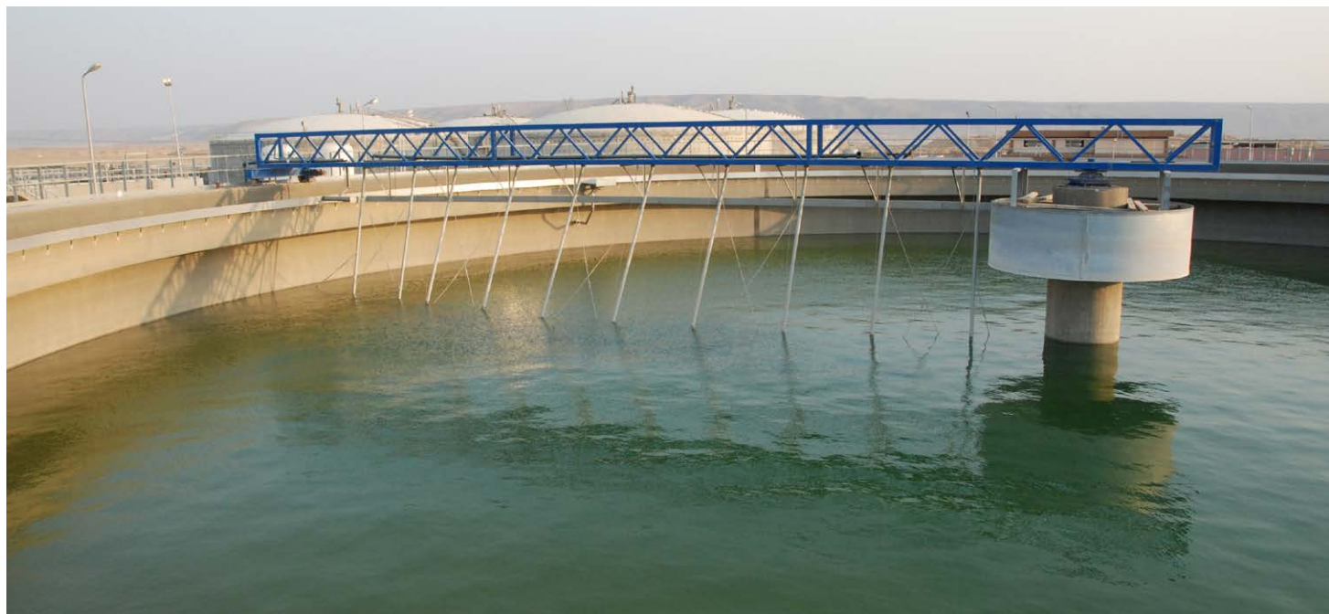
Depuradora New Cairo (Egipto).
